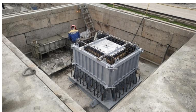
Рисунок 4 - Пропарочная камера для изготовления железобетонных изделий, без крышки
